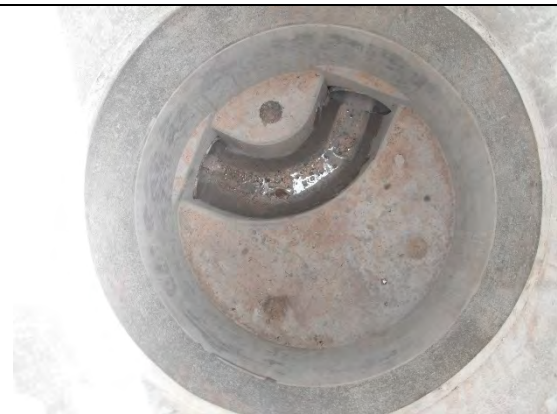
Vue de l'intérieur d'un regard de visite neuf
