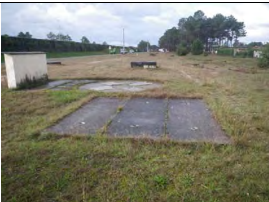
Poste Injection – allée de Malpont
