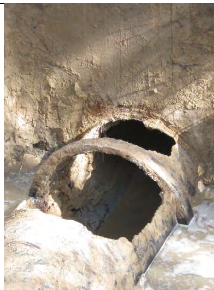
La canalisation cassée
