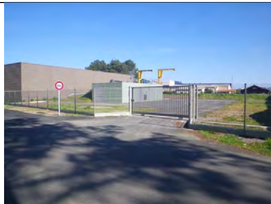
Poste de pompage Perrault
