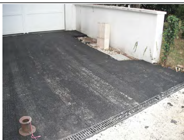
Localisation d'un branchement à changer
