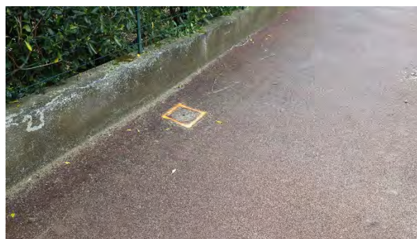
Boîte non étanche à changer
