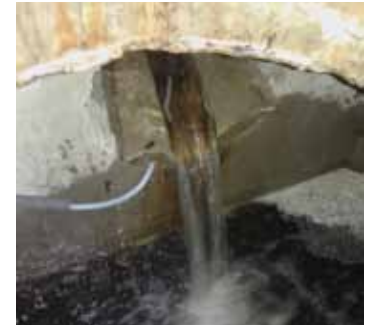
Prise d'eau du préleveur
