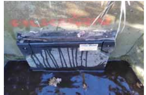
Vue du clapet
