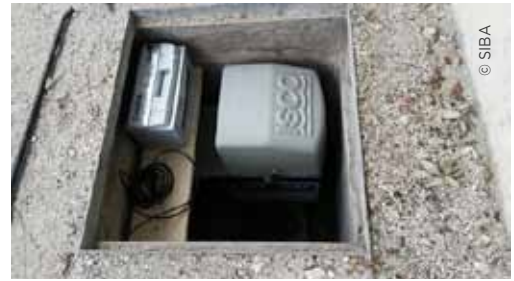
Préleveur automatique installé dans le regard aménagé dans la voirie .
