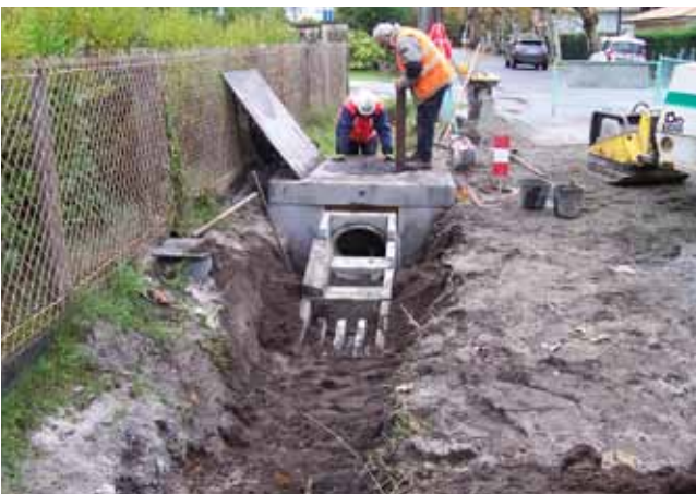
Ouvrage en tête de réseau
