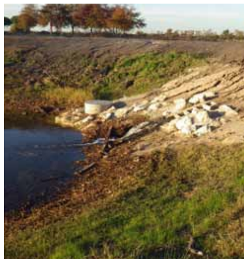
Refoulement vers bassin de Pétioun
