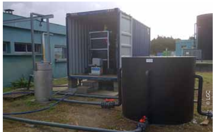
Pilote de traitement (bioréacteur à membranes) en situation sur la station d'épuration de La Teste de Buch
