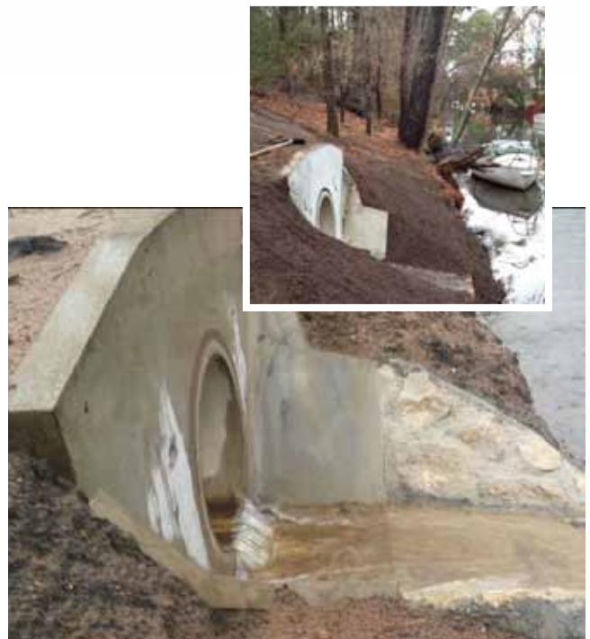
Exutoire dans le canal
