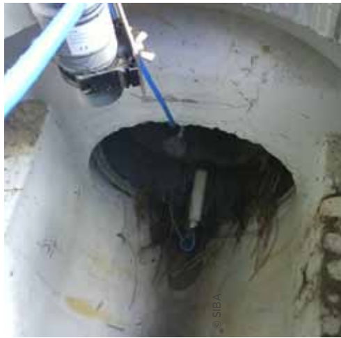
Capteur de hauteur installé dans la canalisation d'eaux pluviales.
