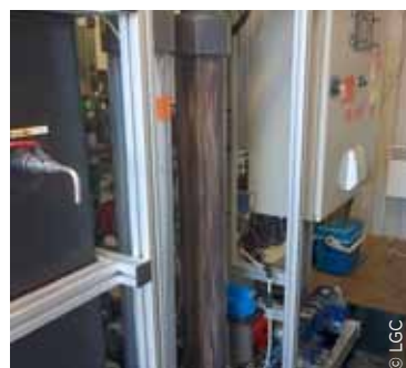
Détail des membranes de filtration du pilote.
