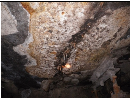
Détail d'une fissure dans la bache à boues
