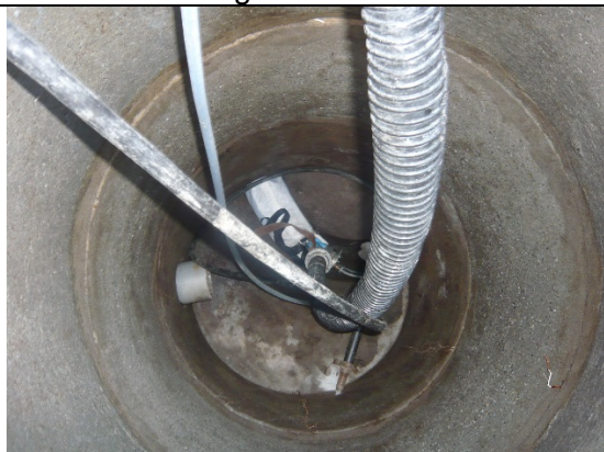
Vue dans un regard de visite pendant l’opération de gonflage de la gaine
