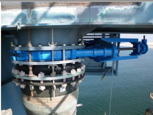
Détail du point de raccordement
