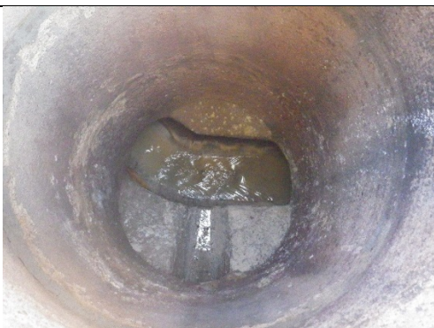
Vue de l'écoulement dans un regard béton
