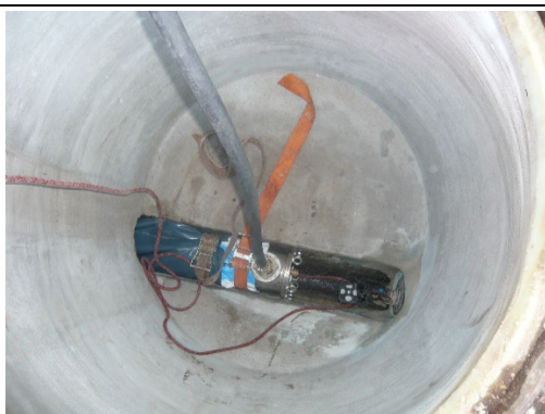
Vue de la gaine en cours de chauffage dans un regard de visite rénové
