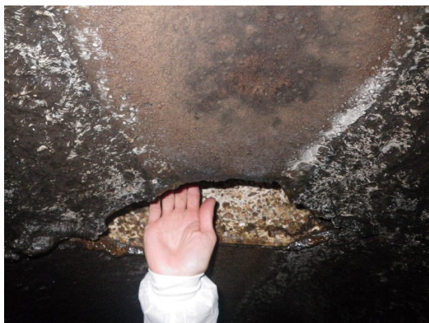
Détail d'un désordre sur la conduite en béton existante
