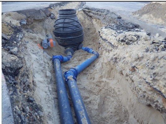
Reprise des canalisations de refoulement venant des postes « Pervenches » et « Dulas » au niveau du giratoire boulevard de la Côte d'Argent – rue François de Fénelon
