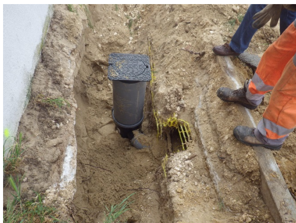
Vue de la nouvelle boîte de branchement
