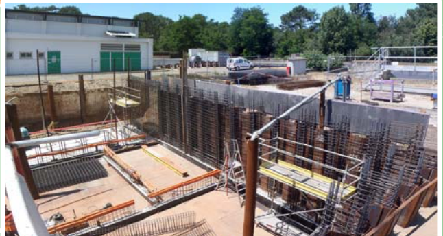
Poste de pompage ZI La Teste
