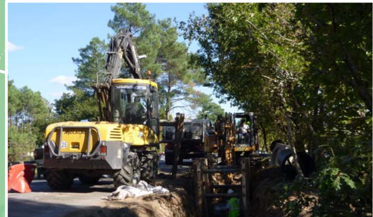
LÈGE-CAP FERRET, Chemin de Cassieu Découpage hydraulique d'un bassin versant, pour soulager le centre ville
