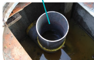
Ouvrage de régulation ou surverse (photo: surverse avec coude vers le haut).
