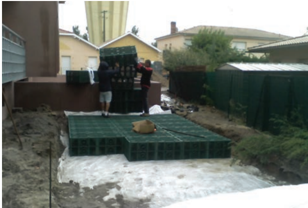
Stockage et infiltration des eaux de toitures d'une résidence, sous espace vert.
