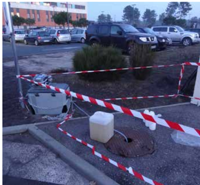
Préleveur en place sur le poste de relevage du Pôle de Santé d'Arcachon.
