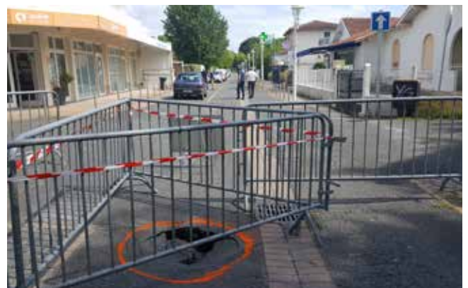
Effondrements à Lanton, rue Guy Célérier
