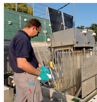
Traitement tertiaire par UV
