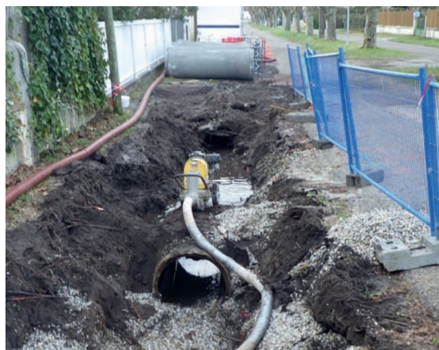
Casse sur réseau, Boulevard de l'Union, Andernos
