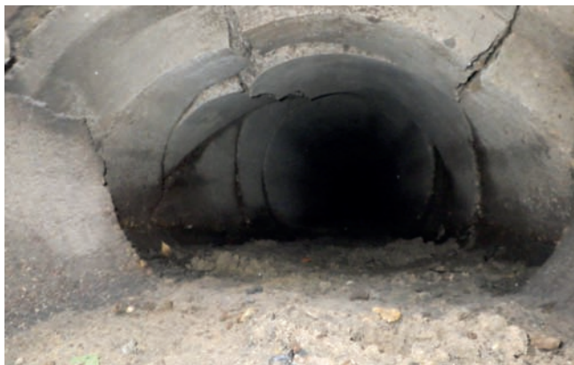
Extrait de l'inspection télévisuelle du réseau endommagé avec affaissement sur voirie, Gujan-Mestras
