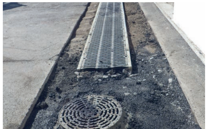
Vue du caniveau et de son exutoire constitué d'un puit d'infiltration, Arcachon
