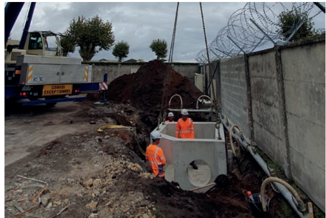
Pose d'un regard préfabriqué sur-mesure pour le raccordement au réseau de la base aérienne, La Teste de Buch
