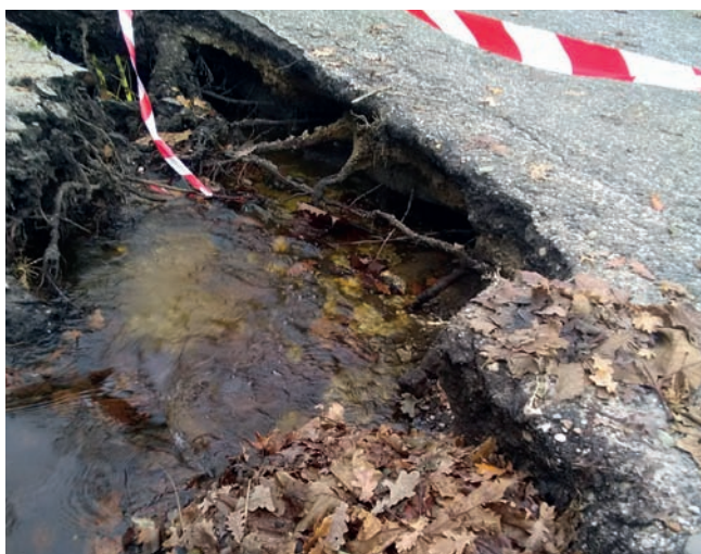
Casse sur réseau, Boulevard de l'Union, Andernos
