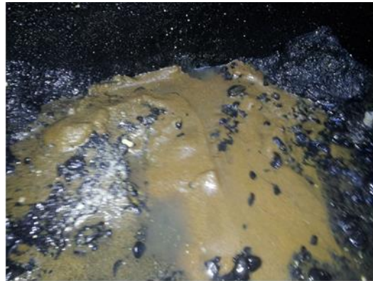
infiltrations en fond de bache
