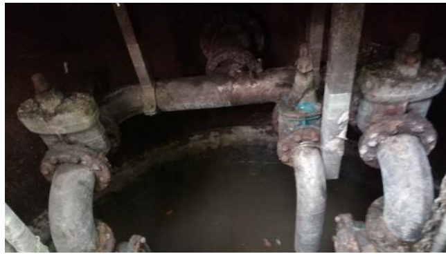
PR bourgeon – poste en mauvais état – hydraulique à refaire
