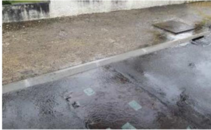
PR Armagnac 2 écoulement pluvial à revoir
