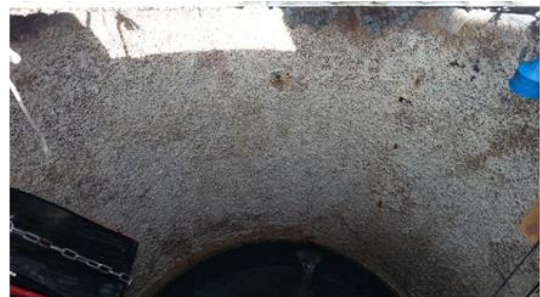
PR Malakoff dégradation du béton de la bache
