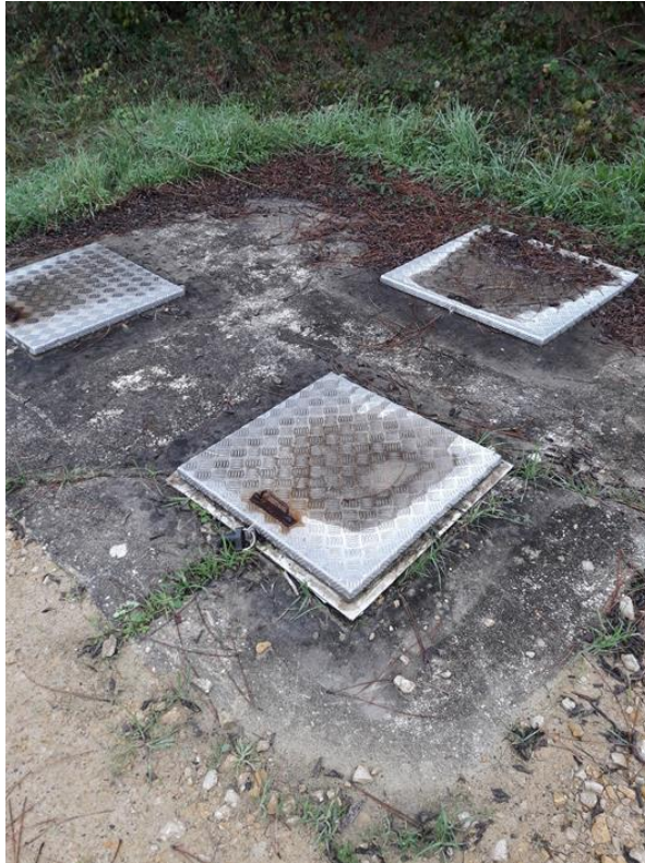
PR Les dunes –dalles dégradées à renouveler
