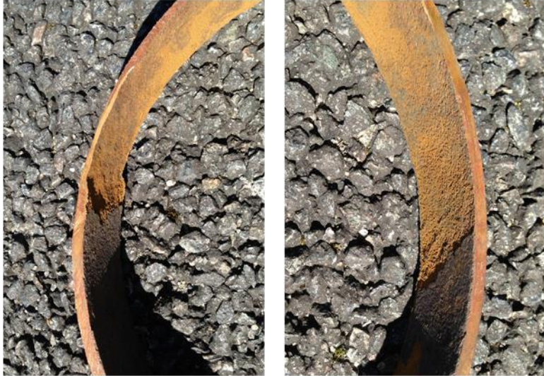
conduite de refoulement du PR Malakoff corrosion intérieure
