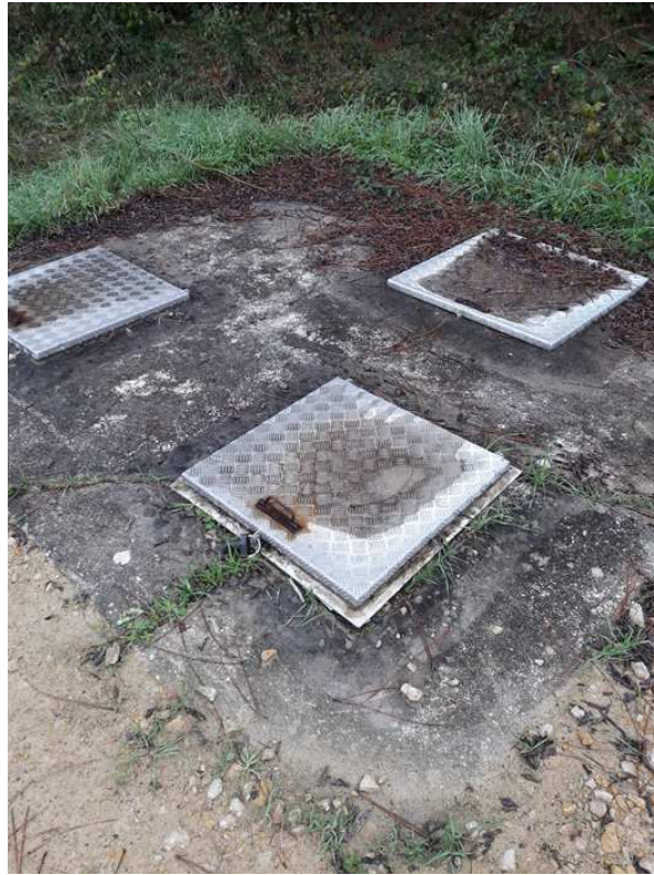
PR Les dunes –dalles dégradées à renouveler
