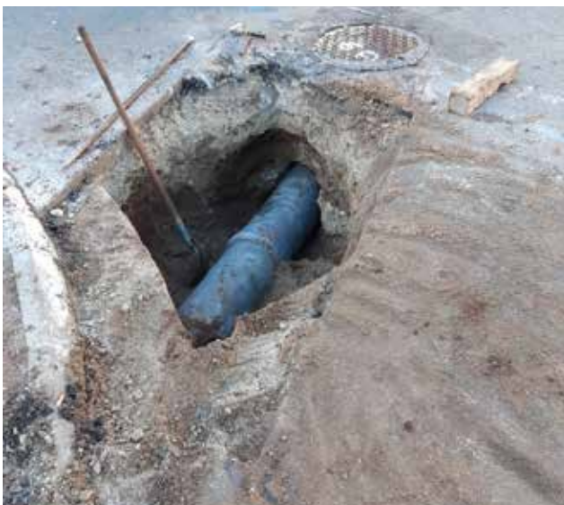
Reprise d'une canalisation affaissée Arcachon
