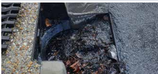
Avaloir obstrué à l'origine d'une inondation Lanton
