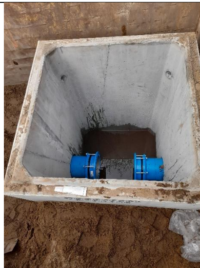
Vue d'un regard de ventouse
