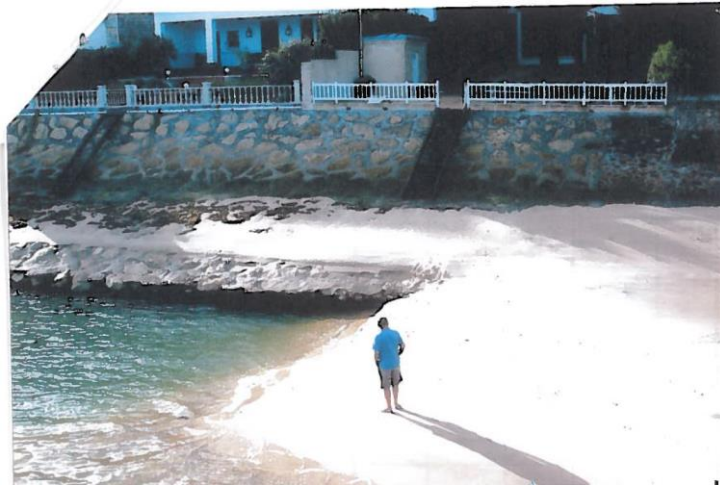
Effondrement de la plage suite à la tempête du 3 octobre 2006 entre la jetée de la Chapelle et la rue Saint-François d'Assise (source : Association Syndicale de Défense contre la mer d'Arcachon)
