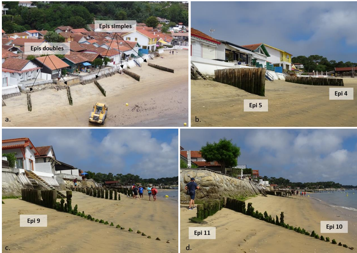
Figure 23. a. Vue drone des épis 4 à 6 simples et 7 et 8 doublés, b. Epi 4 et 5 en bon état, c. et d. Epi 9 à 11 en mauvais état (CASAGEC, 2021).
